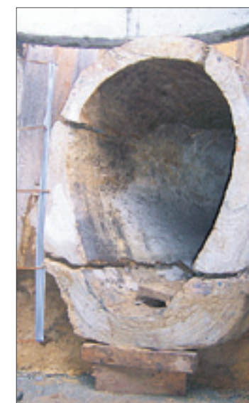
Nach Jahrzehnten harter Beanspruchung sind die Fürstenwalder Abwasserkanäle an vielen Stellen deutlich sanierungsbedürftig.
