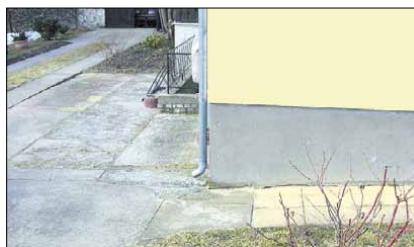
Aus der Dachrinne, aus dem Sinn? Keinesfalls darf das Regenwasser über die versiegelten Flächen in den Schmutzwasserkanal fließen.
