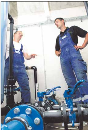
Gelungener Eigenbau: Steffen Braun und Daniel Senzky in der Druckerhöhungsanlage Rauhen.
