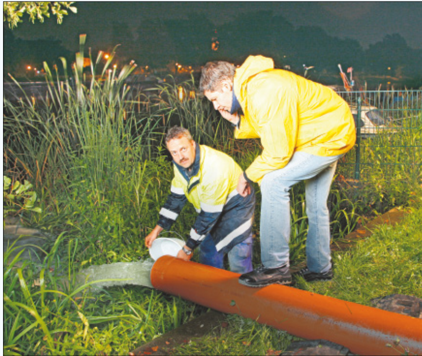
Was machen ZVWA-Mitarbeiter eigentlich des Nachts? – Nun, sie spülen beispielsweise Leitungsabschnitte in den verbrauchsarmen Stunden, um Versorgungsbeeinträchtigungen möglichst gering zu halten. Vom 8. zum 9. September waren Prozessingenieur Sebastian Müller (r.) und seine Kollegen u. a. zwischen Spreewälder und Rudolf-Breitscheid-Straße zugange. Ulf Richter nimmt gerade eine Wasserprobe.
