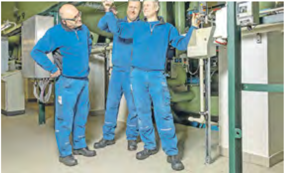
Geprüft und für gut befunden! Die Kollegen Reiner Schulz, Urs Walter und Johannes Weidner (v.l.) prüfen im Wasserwerk Fürstenwalde das Lebenselixier.
