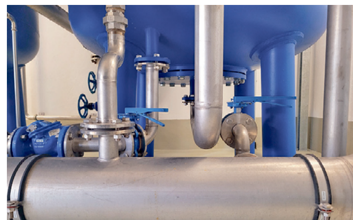
Edelstahlrohre, wie hier im Wasserwerk Markgrafpieske, sollen auch im Wasserwerk Fürstenwalde verbaut werden.
